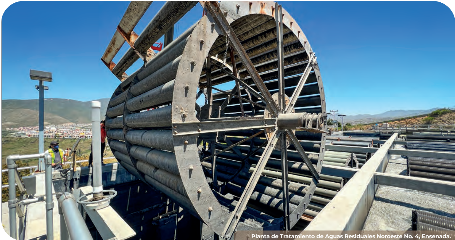
Planta de Tratamiento de Aguas Residuales Noroeste No. 4, Ensenada.
